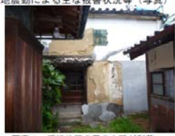
写真1 湯浅地区の蔵の土壁が剥落
