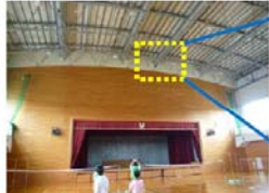
写真3-1 広川町民体育館内の壁が剥落
