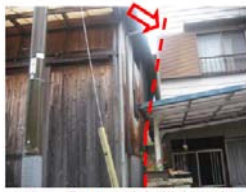
写真2 湯浅地区の倉庫が住宅側（南側）に傾斜（矢印部分）
