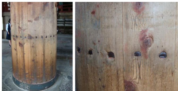
Figura 2 – Detalle del refuerzo estructural del pilar en madera de obtusa (ciprés japonés) Templo Tōdai-ji in Nara (archivo del autor, junio 2013)
