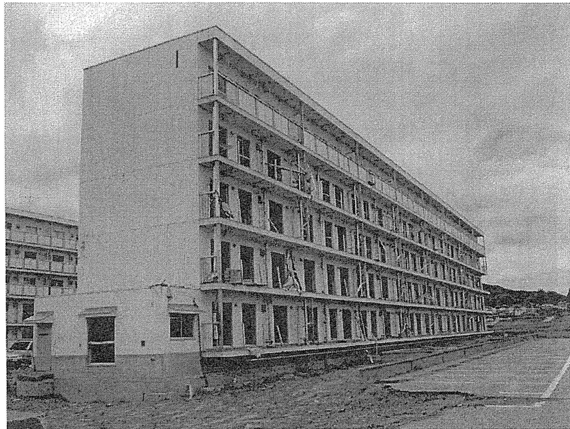
写真 3.3.4 海側にある雇用促進住宅の南面の被害状況
