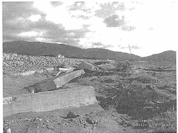
写真 3.3.11 津波で崩壊した防潮堤 (背後の碎石積みは仮設防潮堤)
