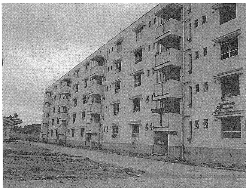
写真 3.3.7 山側にある雇用促進住宅の北面の被害状況
