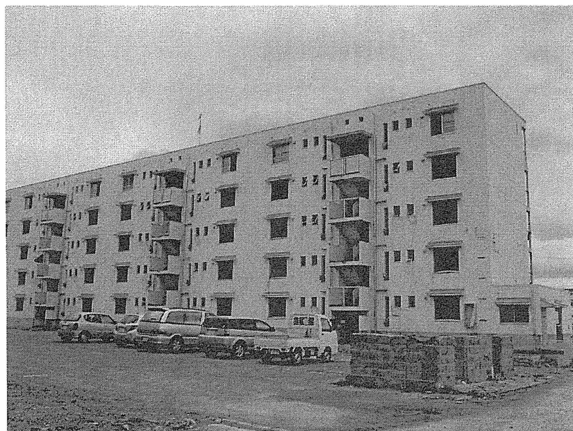
写真 3.3.6 海側にある雇用促進住宅の北面の被害状況
