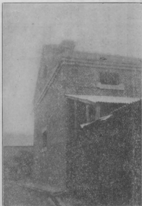
第二圖と同一倉庫の西端裂目
