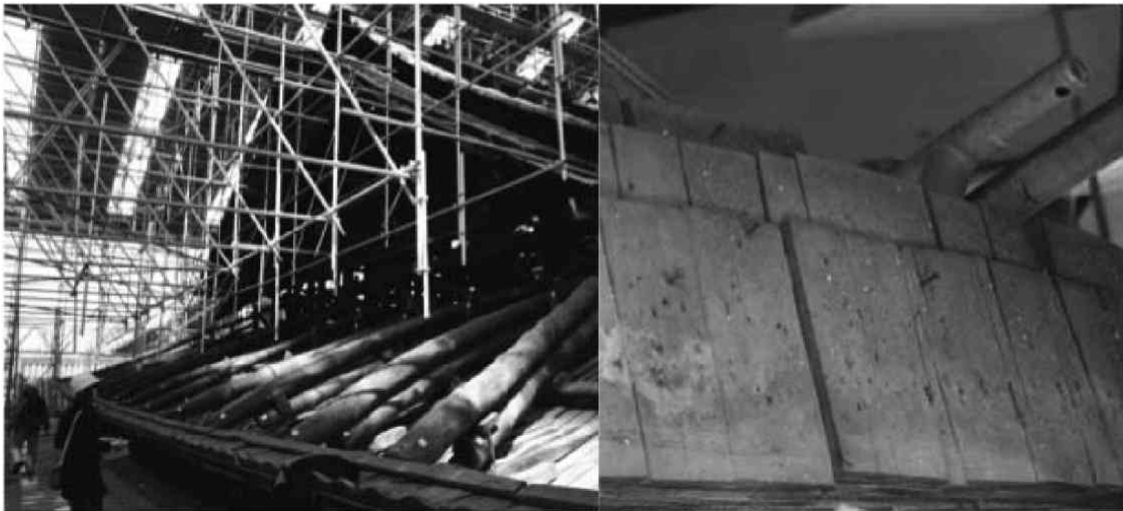
図1 知恩院集會堂修復工事の様子(左)と土居葺(右)。大屋根の土居葺は耐水性の高い樹種として現場では知られるサワラであった。造営関係文書には木曾サワラを8600丁との記述も見つかかり、当時の用材選択と木材流通を知る上で重要な知見が得られた 1) 。
