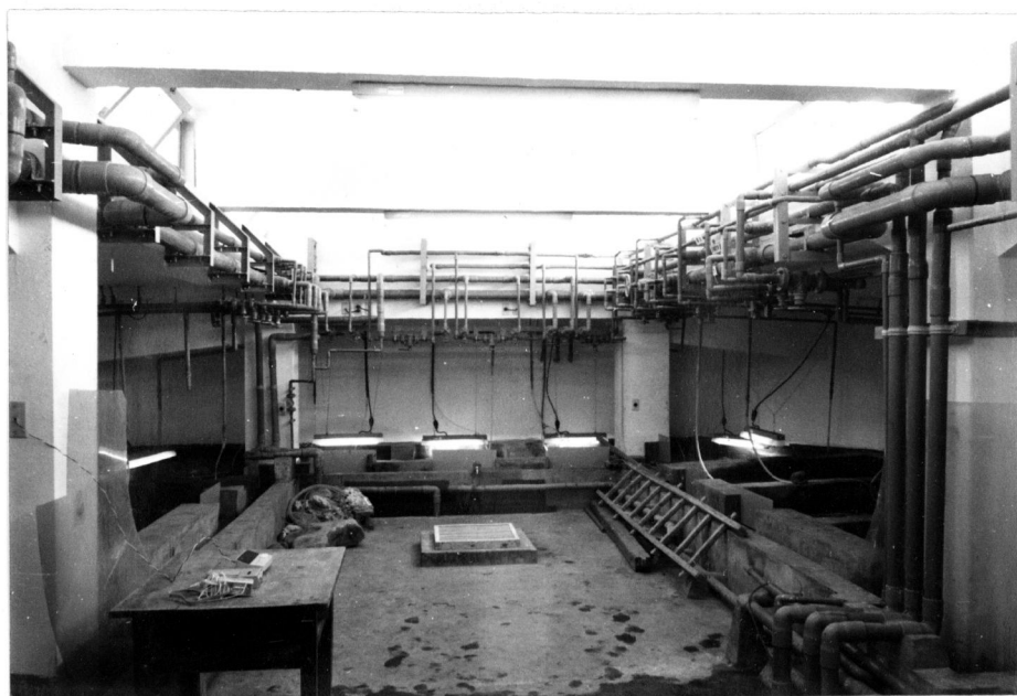
作業室北側： 圧搾空気，自然海水，冷暖房海水の給水（気）管 が集り複雑な配管になっている。中央にみえる四角の木枠は機械 室の換気孔
