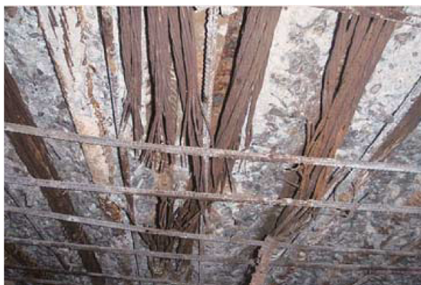
(a) PC 鋼材の腐食
