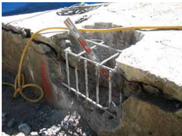
図-1.2 ASRによりフーチングの上面鉄筋が破断した例
