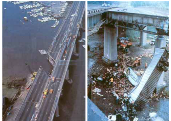
(b) マイアナス橋の落橋状況
