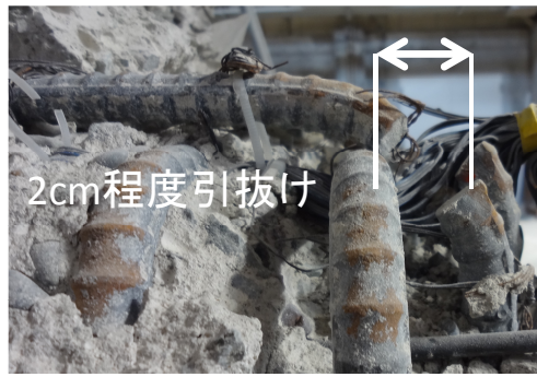
写真-4.12 実験終了後の上面鉄筋の状況
