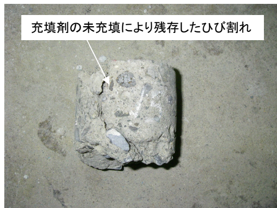
図-4.27 ひび割れ充填剤の未充填の状況
