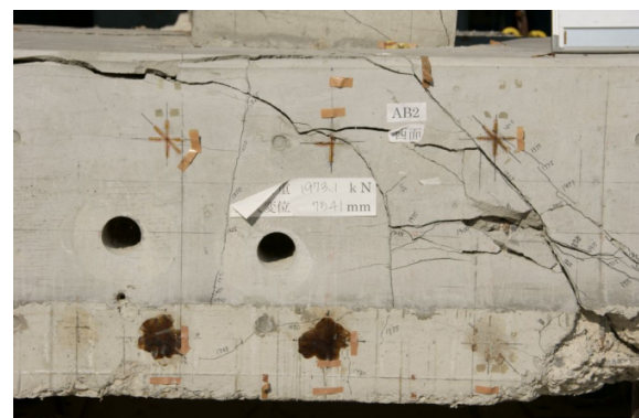
(c) 西側側面に発生した曲げひび割れ
