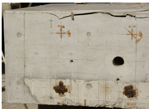
(b) 西側側面に発生したせん断ひび割れ
