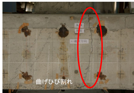
(c) 東側側面に発生した曲げひび割れ
