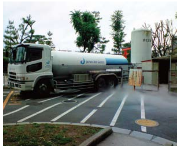
図1 タンクローリーから貯蔵タンクへ液体窒素充填の様子
