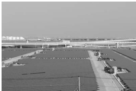
(a) 東京電力浮島太陽光発電所
