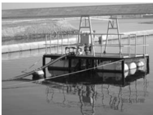
写真-2.1 揚水ポンプの例
