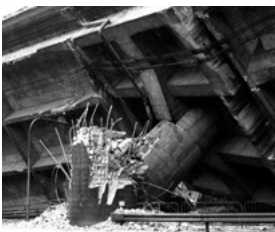
高速道路のピルツ橋の倒壊
