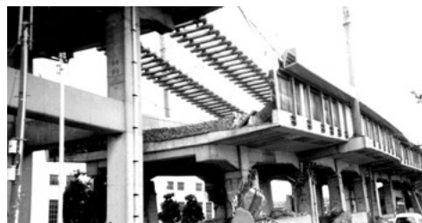
▶資料15 1995年阪神・淡路大震災による山陽新幹線の高架橋の落橋
