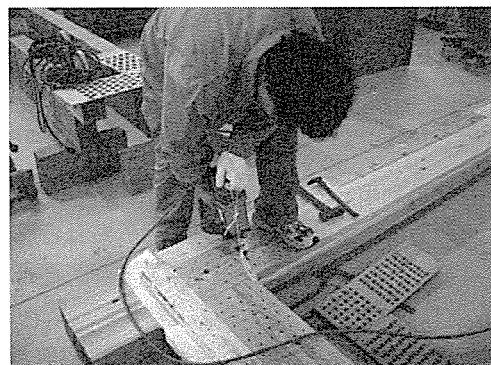
写真-3: リブフレーム製作釘打ち作業 Photo-3: Nailing work for rib-frame manufacture
