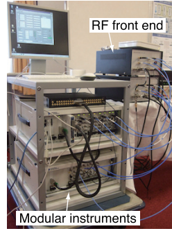
図 2 基地局装置の外観 Fig. 2 Base station (BS).
