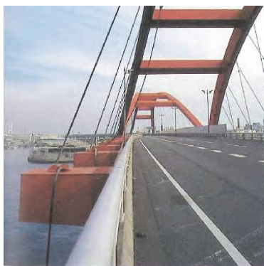
(a) ケーブル脱落状況
