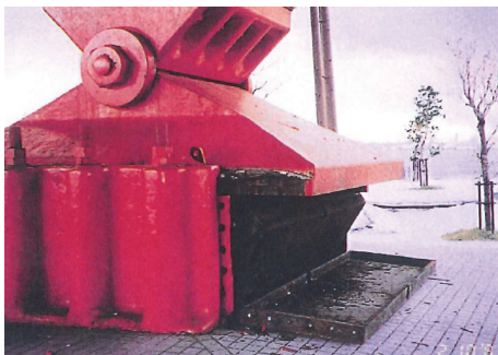
写真1.1 中路的鋼アーチ橋のロッカー支承の損傷
