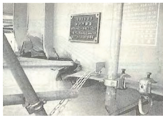
(b) 隣接桁の支承・桁損傷状況
