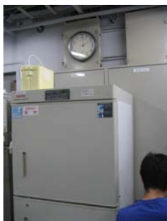
配電盤前の重量物
