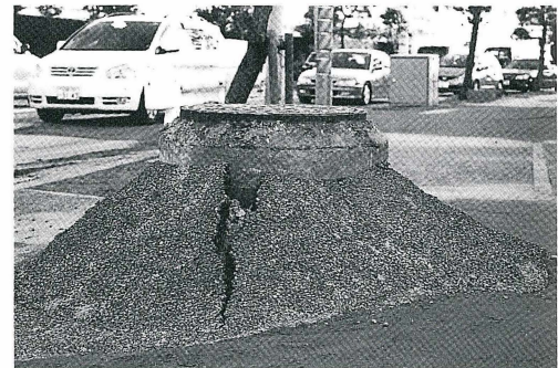
写真15 浮上ったマンホール（浦安市日の出）
