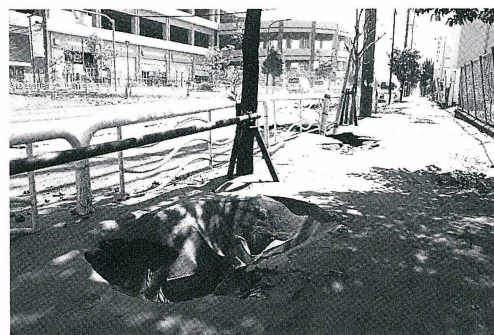
写真2 歩道を覆った噴砂（新木場）
