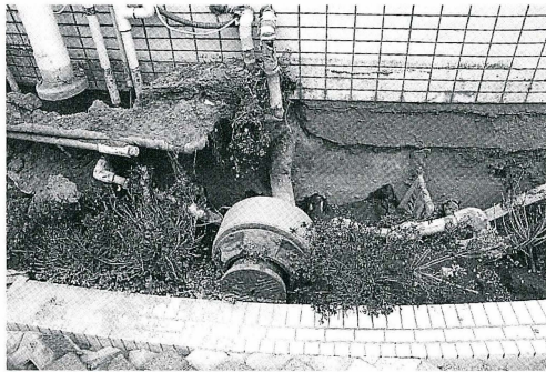
写真12 フレキシブルジョイント（浦安市日の出）
