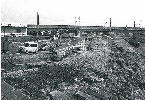
写真1 江合橋左岸下流側の堤防盛土の被害 (撮影日：2011/3/14)
