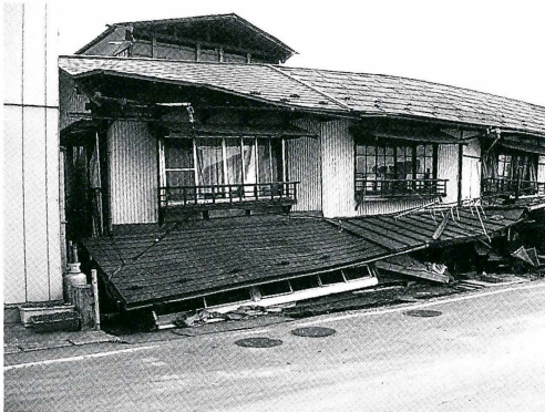
写真5 大崎市古川中里の木造家屋の被害（撮影日：2011/3/14）
