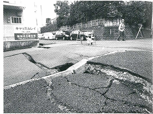
写真2 仙台市青葉区桜ヶ丘4丁目の斜面上に認められた路面のクラック (撮影日：2011/3/14)
