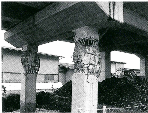
写真3 東北新幹線北上駅－新花巻駅間の第1中曽根BLのラーメン高架橋柱の大きな損傷（撮影日：2011/3/15）
