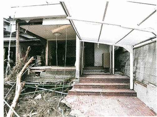
図21 泥流の通り道となった家屋（8月15日）
