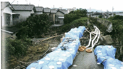
図18 弥陀次郎川の破堤箇所全景（8月15日）
