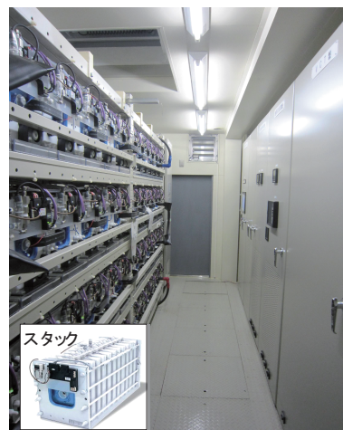
〔図3〕 需給制御の実証試験設備 左側が蓄電池、右側が交直変換器
