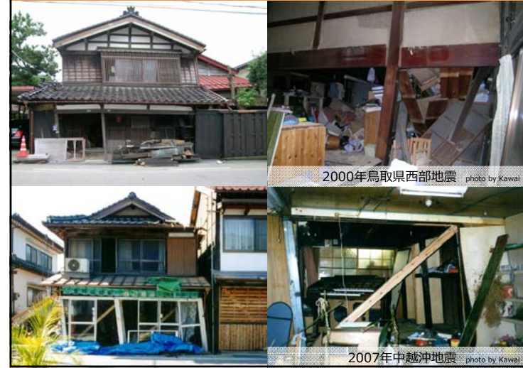
町家型民家の地震被害
