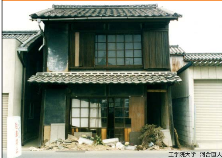
町家型民家の地震被害 (1995年兵庫県南部地震)
