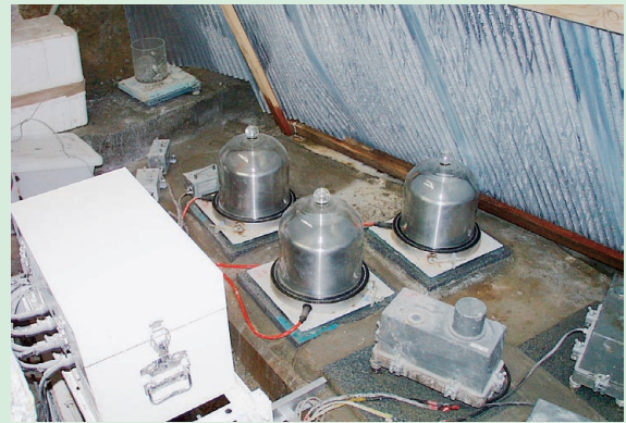
観測坑内に設置された種々の地震計
