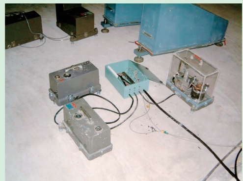
観測坑内に設置された高感度地震計
