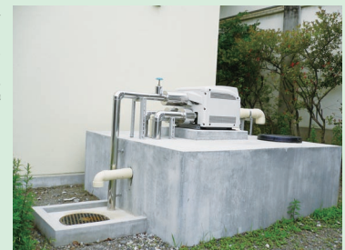
琵琶湖水導水ポンプ
