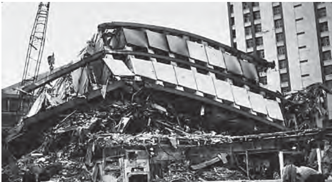
第2-14 図 B 21階建・鉄筋コンクリート造アパート被害（©USGS Photographic Library of Mexico City Earthquake, 1985, No. 13）.
