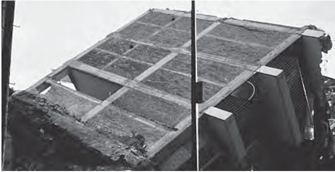
第2-14 図 A 8階建煉瓦造り（壁補強なし）建物被害（©USGS Photographic Library of Mexico City Earthquake, 1985, No. 16）.
