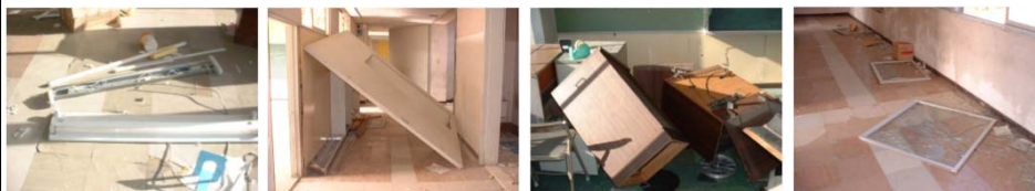
2003年7月26日宮城県北部地震（M6.4）旧河南町北村小学校（震源距離10km程度）の被害事例
