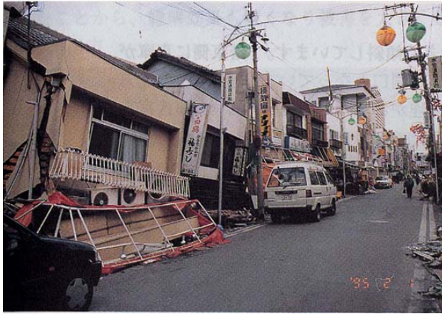
入り口に壁が少なく一方へ崩れ落ちている
