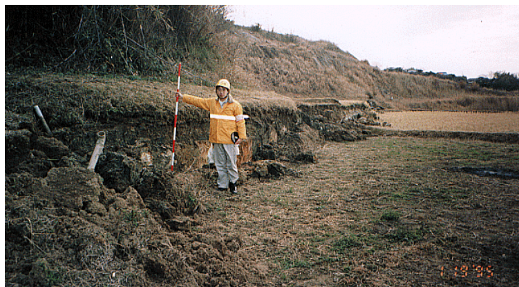
写真-6 北淡町野島平林の断層亀裂
