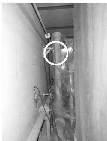
実験機器配管の保温材 (B 研究室)
