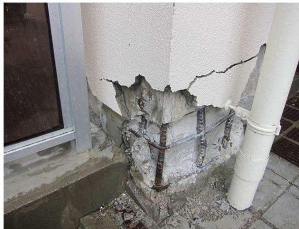
写真1 損傷度Ⅴの柱
