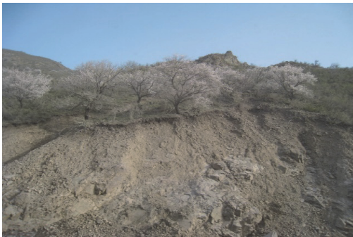
写真3 果子沟の崩壊状況
