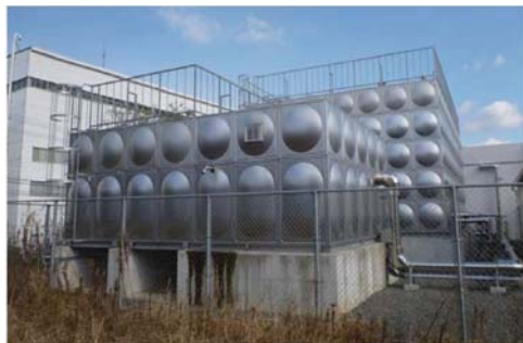
写真3: 新設された2基(500トン、500トン)の受水槽
