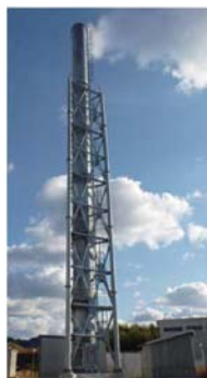
写真5：建て替えられたKURの排気塔（スタック）
