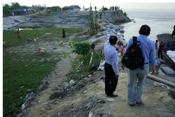
Fig. 8 Dyke breach site (Aug. 10 2014).
