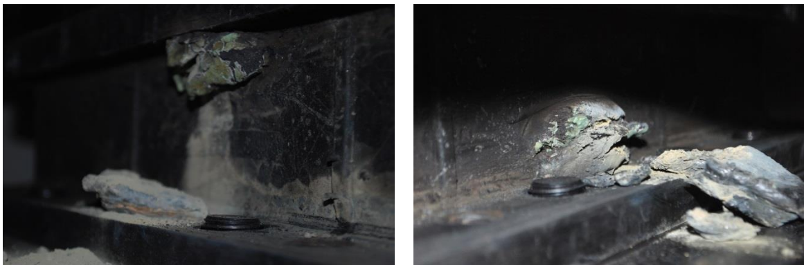
写真-2.3.2 劣化支承側面状況(L1試験载荷終了後)
