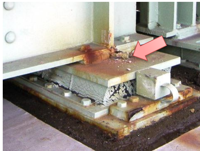
写真-4.2.6 プラグ孔隙間からの鉛プラグの突出
