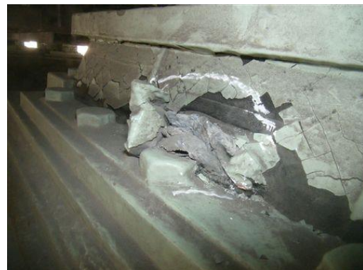
(d) 支承側面からの鉛突出
