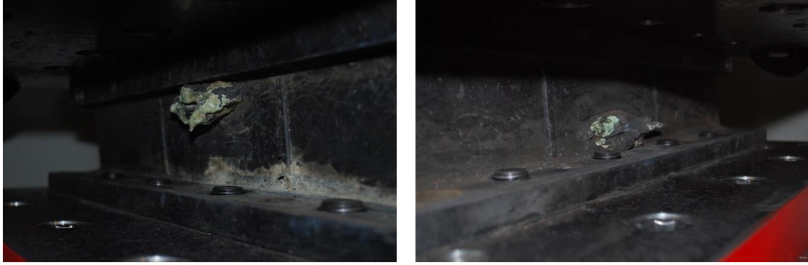
写真-2.3.1 劣化支承側面状況(L1試験载荷開始前)
