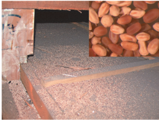
写真 6 : アメリカカンザイシロアリ被害家屋の屋根裏の様子。6 個の窪みがある特徴的な形のフンが被害材より落下・堆積している。フンの大きさは長径で約 1 mm。
