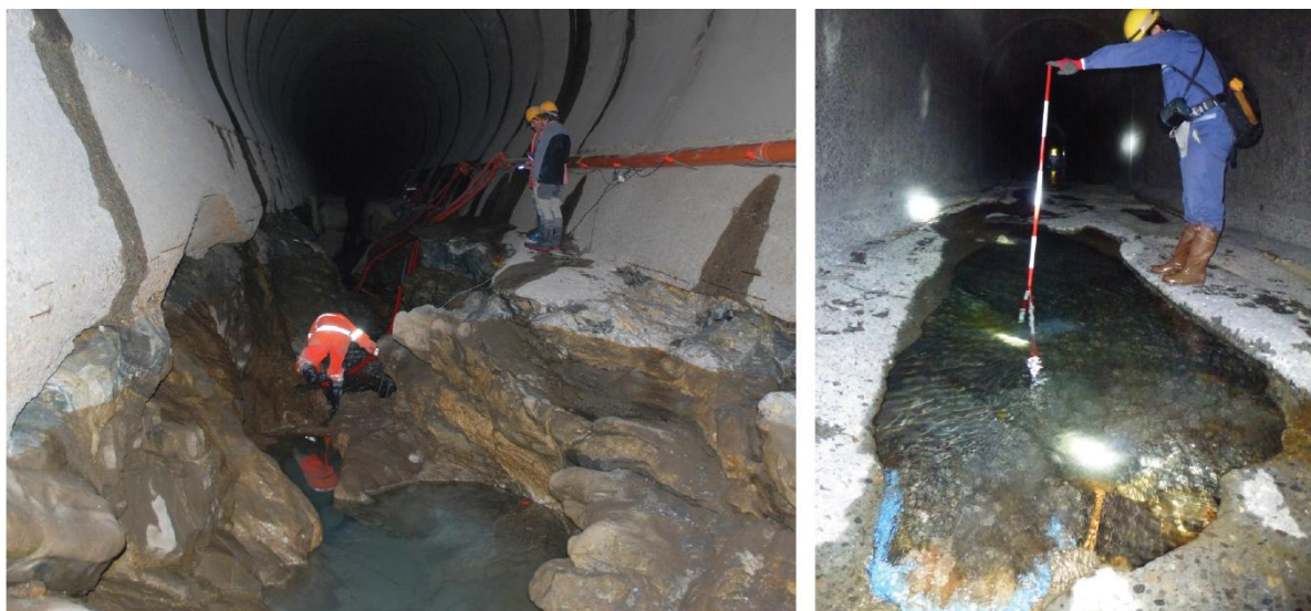
図 5-1 土砂バイパストンネル内の摩耗状況
