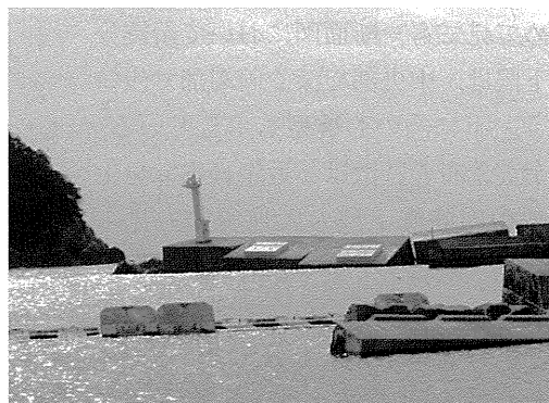
和歌山県周参見漁港の西防波堤の被災
