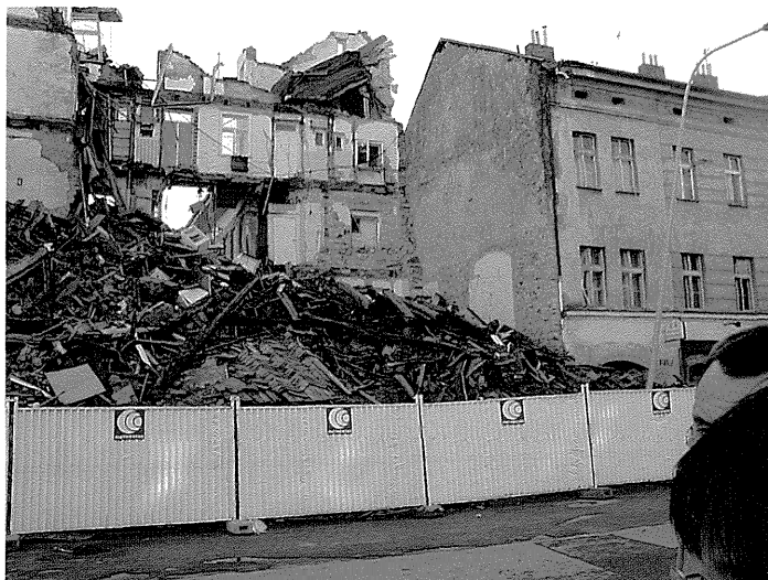
浸水で崩壊した家屋（プラハ市）
