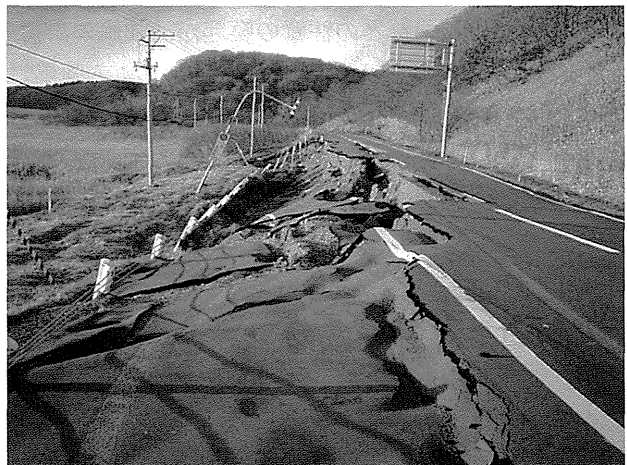
十勝沖地震で発生した道路被害の様子
