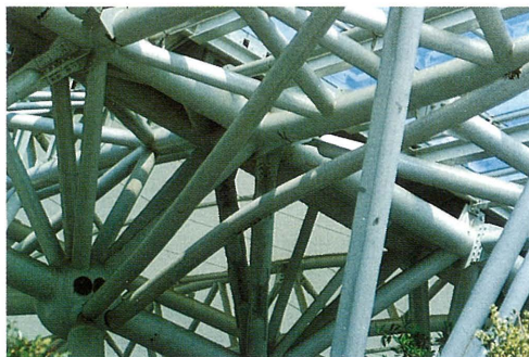
写真-2・4 阪神大震災時の骨組構造の損傷状況
