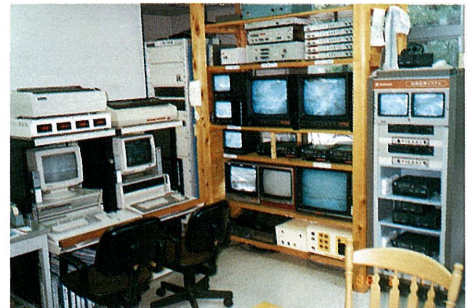
写真-2.15 観測室のモニターとデータ処理装置
