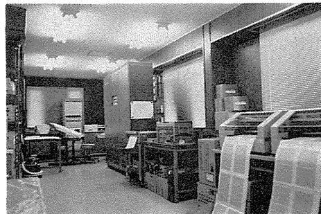
写真-2-22 テレメーター送受信室
