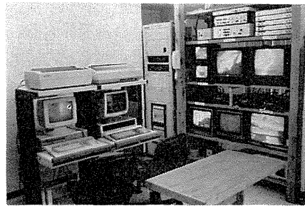
写真-2-38 砂防観測テレメータ・システム（観測室）
