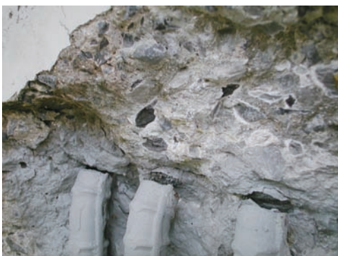
図-4 ASR劣化構造物中の破断した鉄筋
