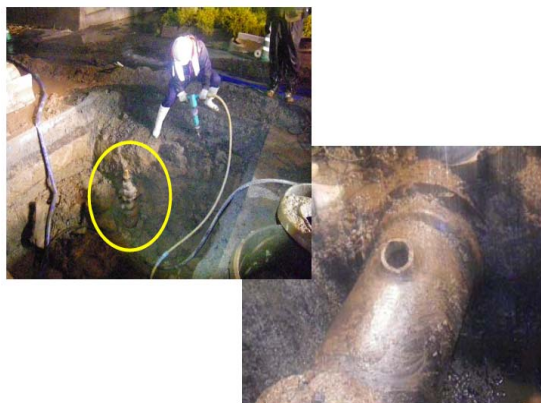
写真-1.3 消火栓の破損 9)
