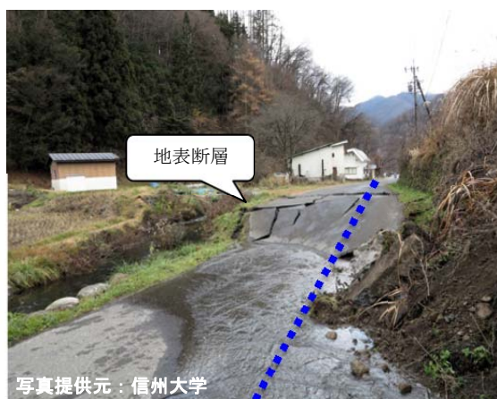
写真-1.11 配管布設ライン 17) (地震直後)
