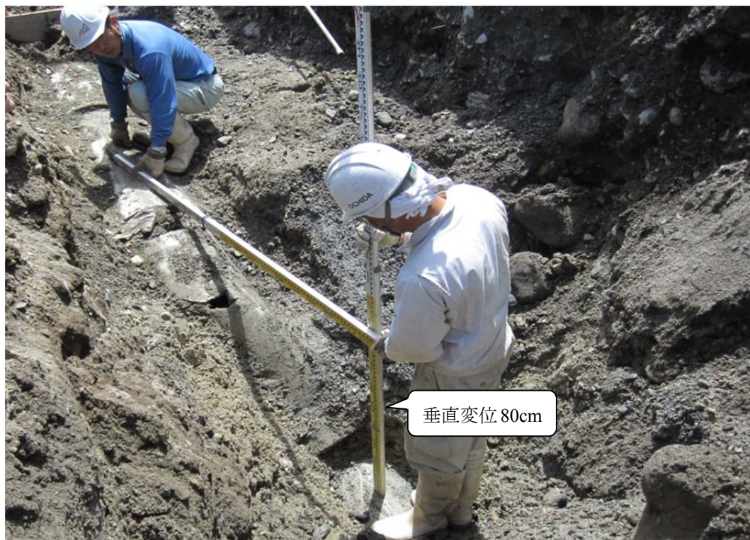
写真-1.17 下水道管（ヒューム管）の変形状況
