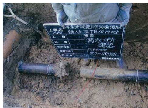
写真-1.2 ダクトイル鋳鉄管の継手抜け 8)
