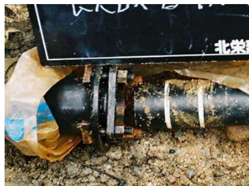
写真-1.6 継手の抜け被害②
