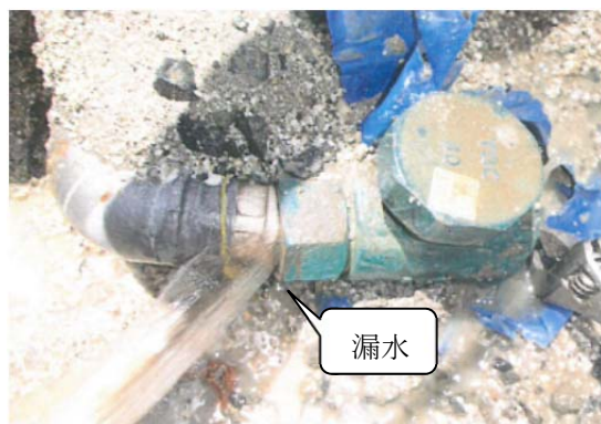
写真-1.9 給水管接合部からの漏水
