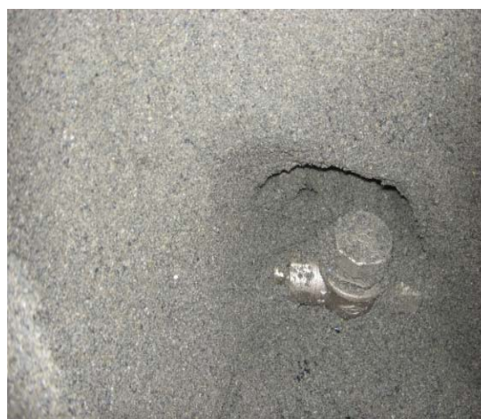
写真-4.17 分岐部側部の空洞 (呼び径 200 給水分岐)
