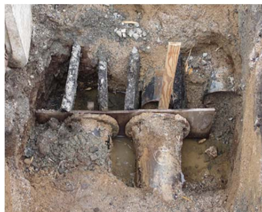
写真-1.4 断層直管に埋設された配管
