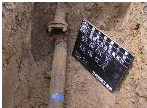
写真-1.5 継手の抜け被害①
