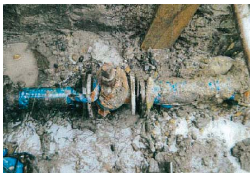
写真-1.1 仕切弁近傍の継手破損 8)
