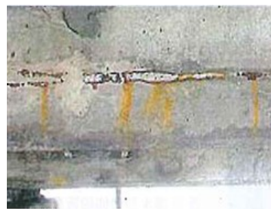
写真 3.5 陽極材の劣化事例
