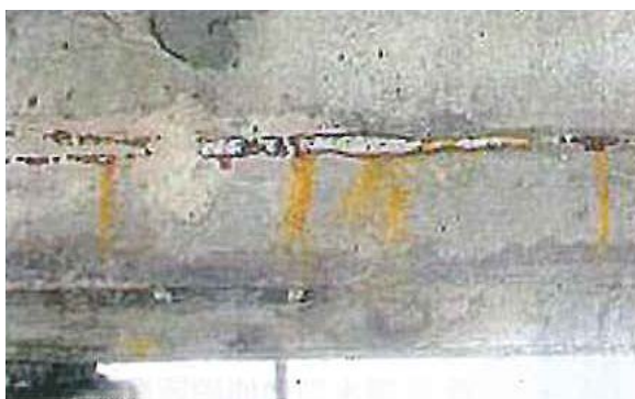
写真2.1 陽極材被覆モルタルの劣化事例
