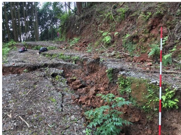
図-5-5 崩壊域上方の段差亀裂
