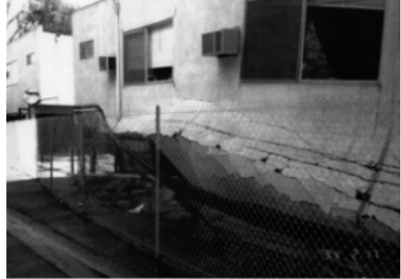
写真15 潰れた駐車場
