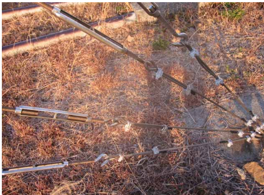
写真11 観測塔のアンカー、支持用ワイヤーとターンバックル
