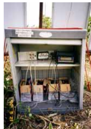
写真 18 バッテリーコントローラーなど
