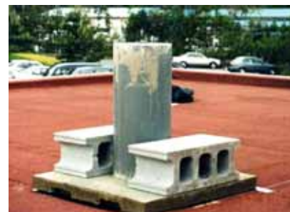
写真 27 大原アンテナ架台
