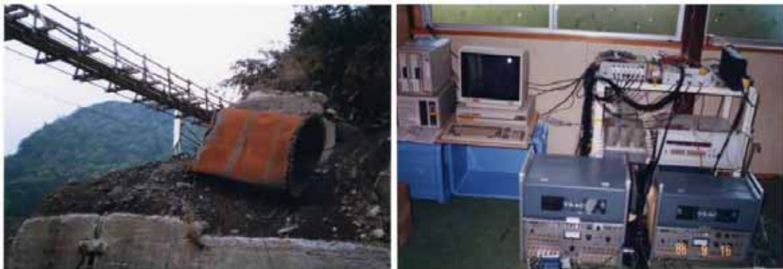
写真20 土石流による送水管断裂とパソコンによる観測装置など
