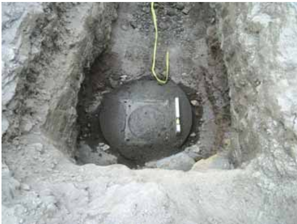
写真3 水管傾斜計センサ部の台
