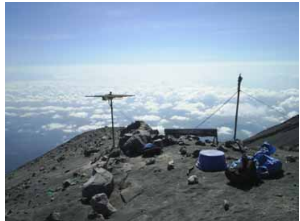
写真6 無線アンテナ(右が今回設置したもの)
