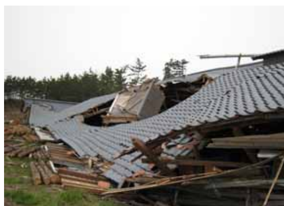
写真2 地震により倒壊した製材所
